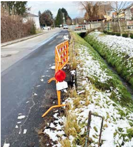
Badstraße wurde bis dato nicht saniert
